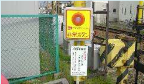
【踏切支障報知装置】
