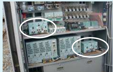
【踏切制御箱（本郷踏切道）】
