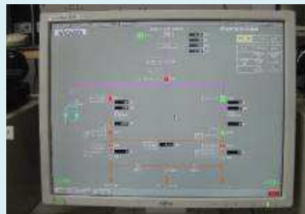
【監視制御卓須坂変電所】
