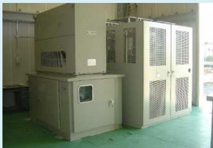
【須坂変電所2号整流装置】
