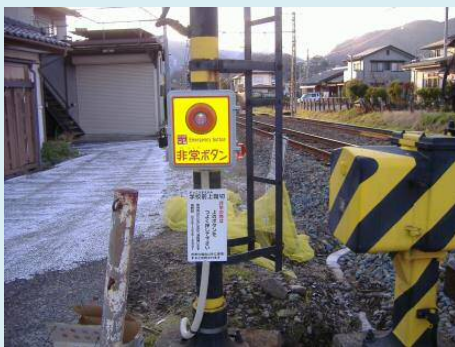
【押しボタン式踏切支障報知装置】
