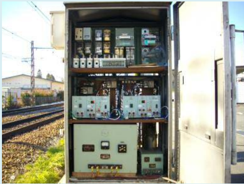
【踏切制御箱 (桐原西踏切道)】
