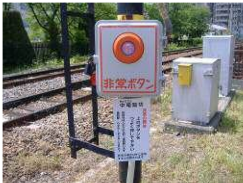
押ボタン式踏切支障報知装置（中電踏切道）
