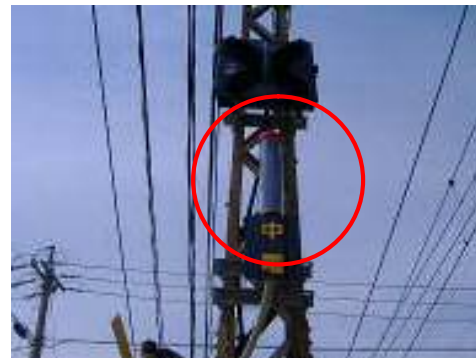
特殊信号発光機（中電踏切道上り用）
