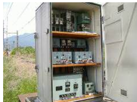
踏切制御箱（栗和田～一本木踏切道）
