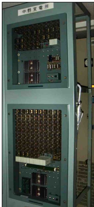
遠隔監視制御装置（旧）
