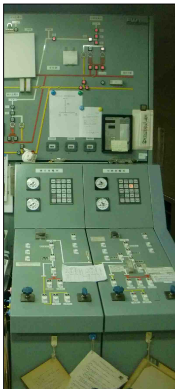
運転司令室制御卓（旧）
