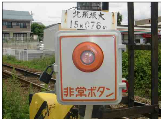
押ボタン式踏切支障報知装置
