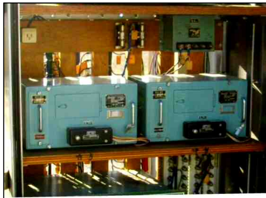
踏切保安送装置 更新前
