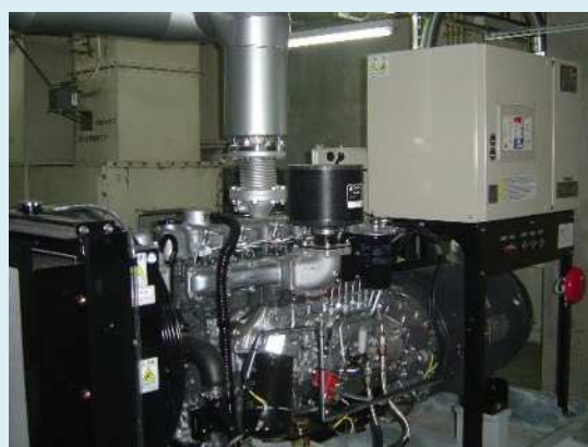
【市役所前駅 非常用発電設備】
